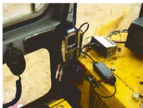
▲移動局システム設置状況
